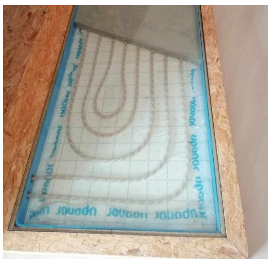
Figura 4.21. Piso Radiante da marca Uponor .
