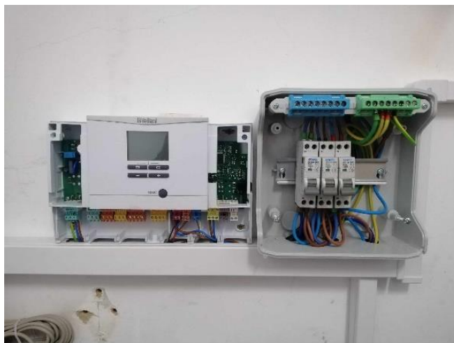
Figura 5.29. Controlador da bomba de calor e quadro elétrico parcial.
