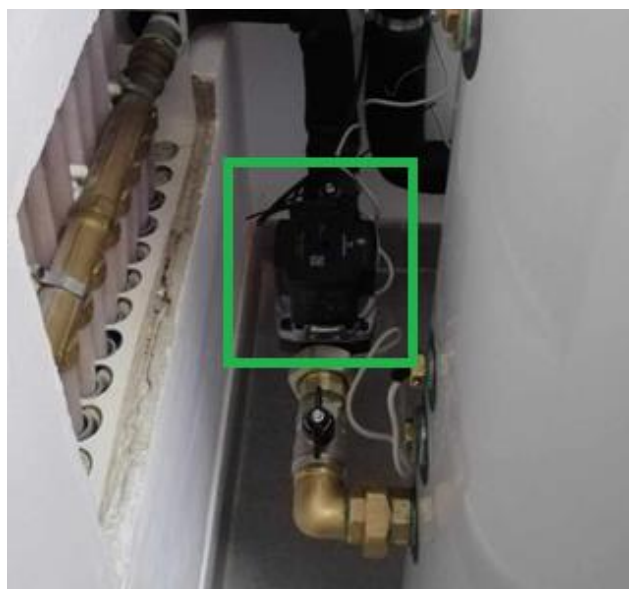
Figura 5.27. Bomba circuladora, Evosta .
