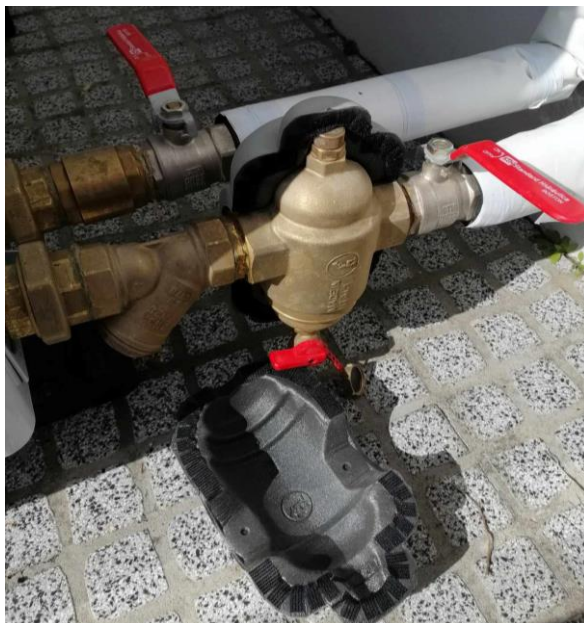
Figura 5.20. Implementação do Filtro Y e separador de sujidade magnético, da marca Caleffi .
