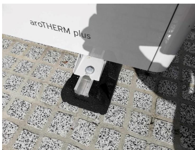
Figura 5.18. Fixação da bomba de calor através de sinoblocos.
