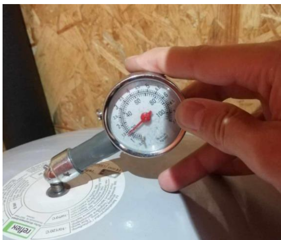
Figura 5.30. Pressão do vaso de expansão do circuito de aquecimento.
