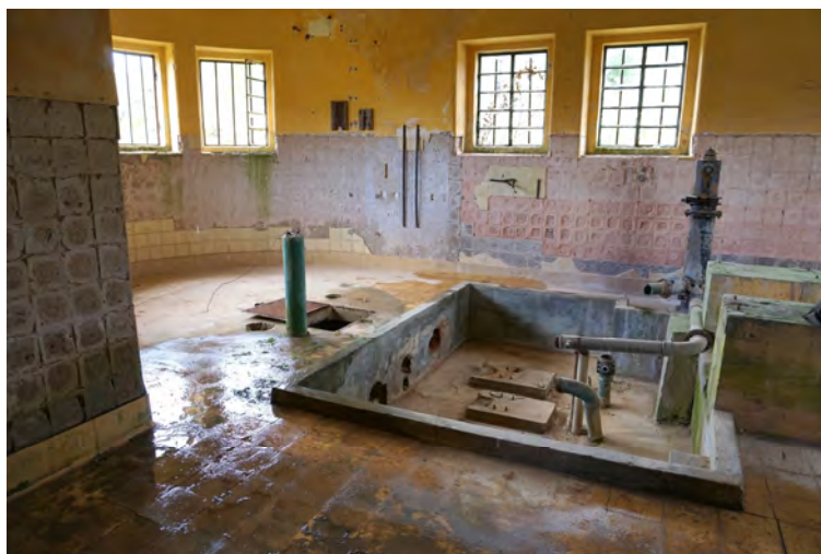
Figura 43 - Levantamento fotográfico do interior da Estação Elevatória de água
