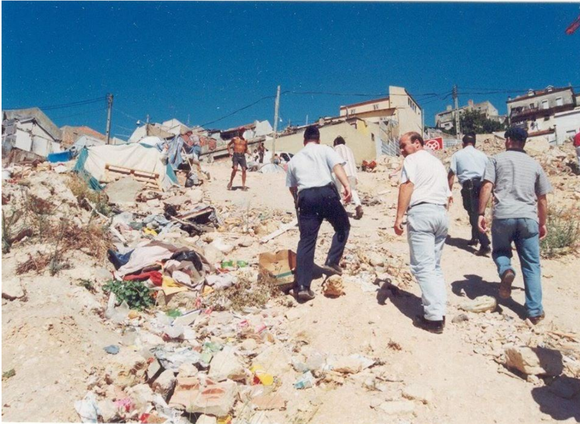
Figura 14 Demolição de barracas do Casal Ventoso. Fonte: Gabinete de Reconversão do Casal Ventoso.
