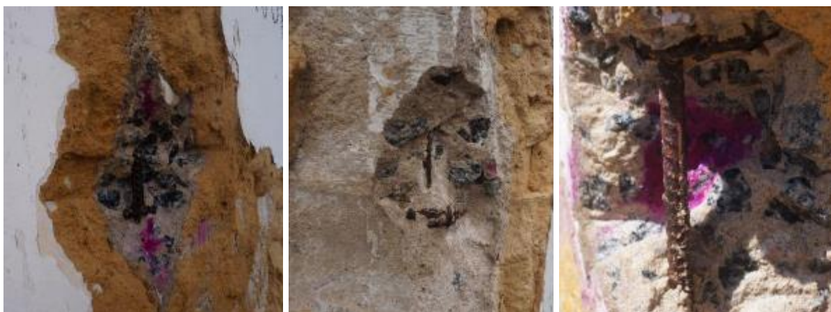
Figura 5.5 – Resultado da aspersão com solução de fenolftaleína em zonas quebradas de fresco de 3 pilares. (Acervo técnico da Tecomat Engenharia)
