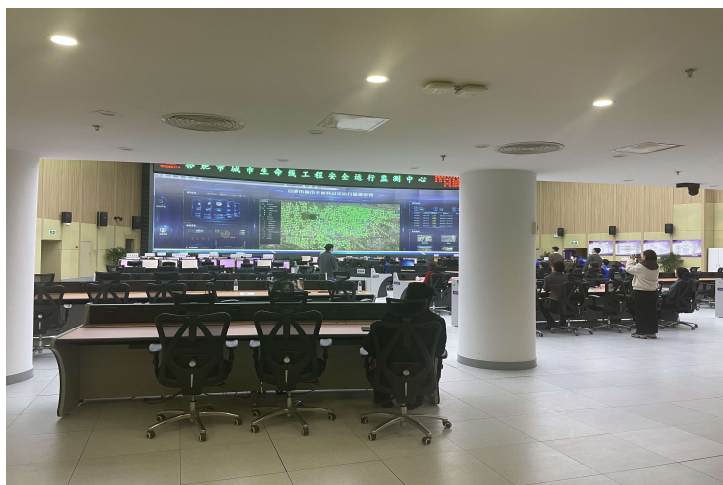
Figura 2.4– Centro de monitorização.
