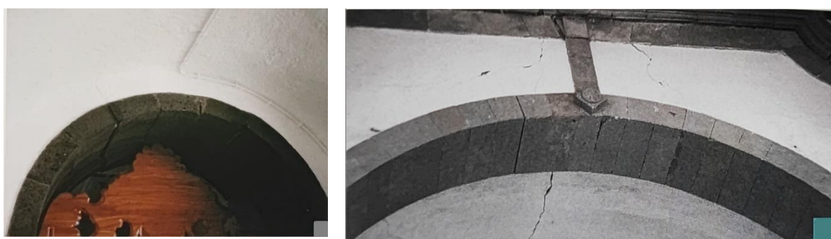
Figura 2.10. Danos em arcos (adaptado de (Azevedo & Guerreiro, 2008)). Imagem da esquerda: Dano em arco da porta de acesso ao batistério na igreja de Candelária (Pico); Imagem da direita: Dano em arco que separa a nave central da cabeceira na igreja da Srª da Graça em Praia de Almoxarife (Faial).
