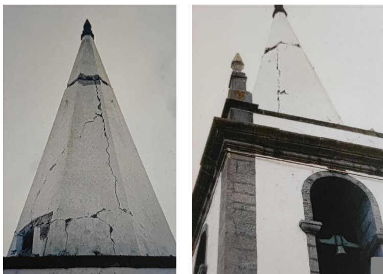
Figura 2.20. Danos na cúpula da torre da igreja de Castelo Branco na ilha do Faial (adaptado de (Azevedo & Guerreiro, 2008)).
