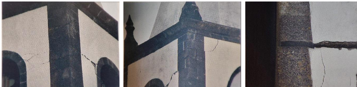
Figura 2.16. Igreja de Bandeiras na ilha do Faial: Fendas em torno das torres e deslizamento de pedra. (adaptado de (Arêde, et al., 2008)).
