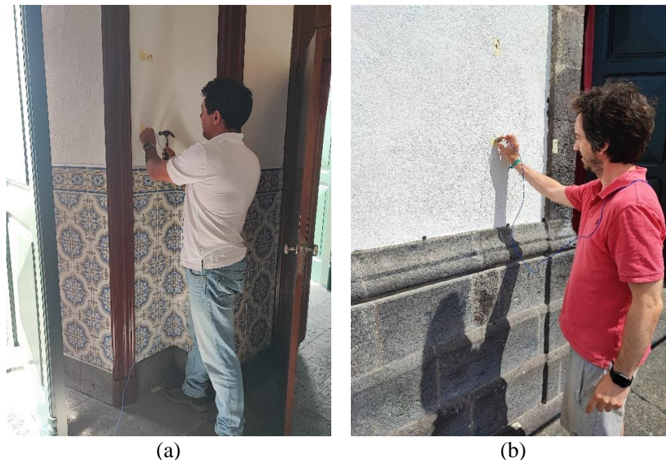
Figura 4.1. Realização de ensaio sónico direto na fachada principal: (a) Martelo não instrumentado e sensor colocado na superfície interior da parede; (b) Sensor colocado na superfície externa da parede.
