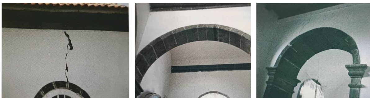
Figura 2.7. Fendas em paredes da igreja de Bandeiras na ilha do Faial (adaptado de (Azevedo & Guerreiro, 2008)).
