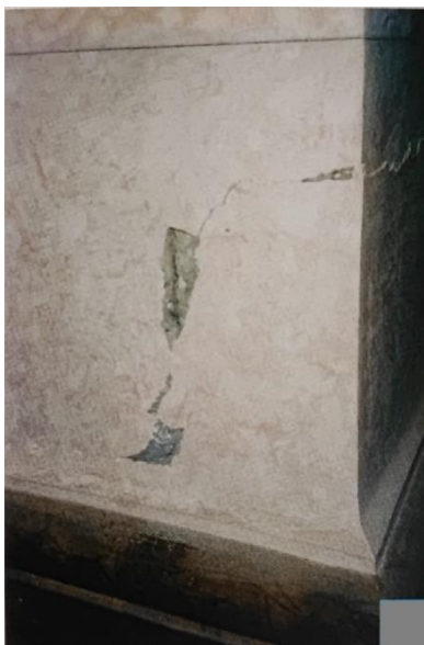
Figura 2.3. Cunha de rotura por compressão presente numa das colunas na igreja de Feteira na ilha do Faial (adaptado de (Azevedo & Guerreiro, 2008)).
