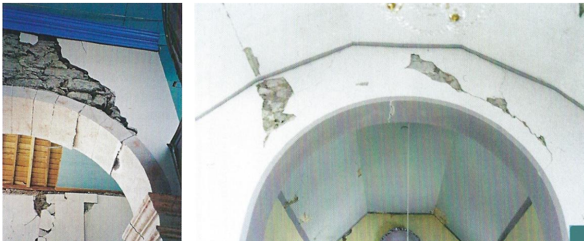
Figura 2.9. Danos em arcos na ilha do Faial (mecanismo 5 e 17) (adaptado de (Azevedo & Guerreiro, 2008)). Imagem da esquerda: Quase colapso dos arcos entre a nave principal e a nave lateral da igreja da Ribeirinha. Imagem da direita: Dano em arco que separa a nave principal da cabeceira na igreja de Ribeira Funda.
