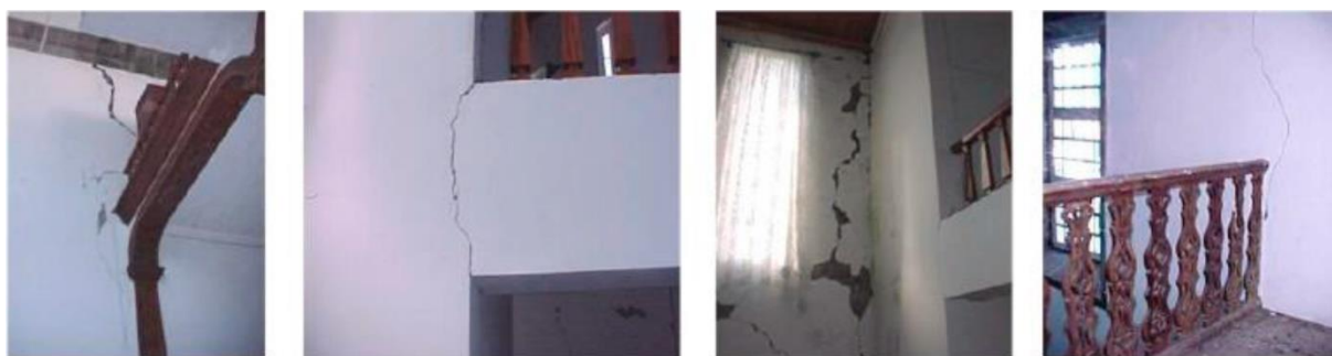
Figura 2.21. Danos resultantes da interação entre coro alto e paredes laterais (adaptado de (Magalhães, et al., 2010)).
