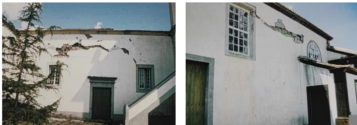
Figura 2.6. Danos em paredes por rotura por choque (adaptado de (Azevedo & Guerreiro, 2008)). Imagem do lado esquerdo: Igreja de Flamengos no Faial; Imagem do lado direito: Igreja de São João no Pico.
