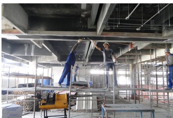
Figura 40. Retirada de bolhas que possam existir sob a camada de fibra - Modulo Engenharia
