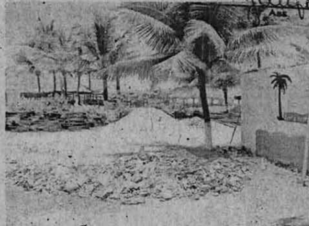
Foto 25 - Bar em reforma. Restos de construção.
