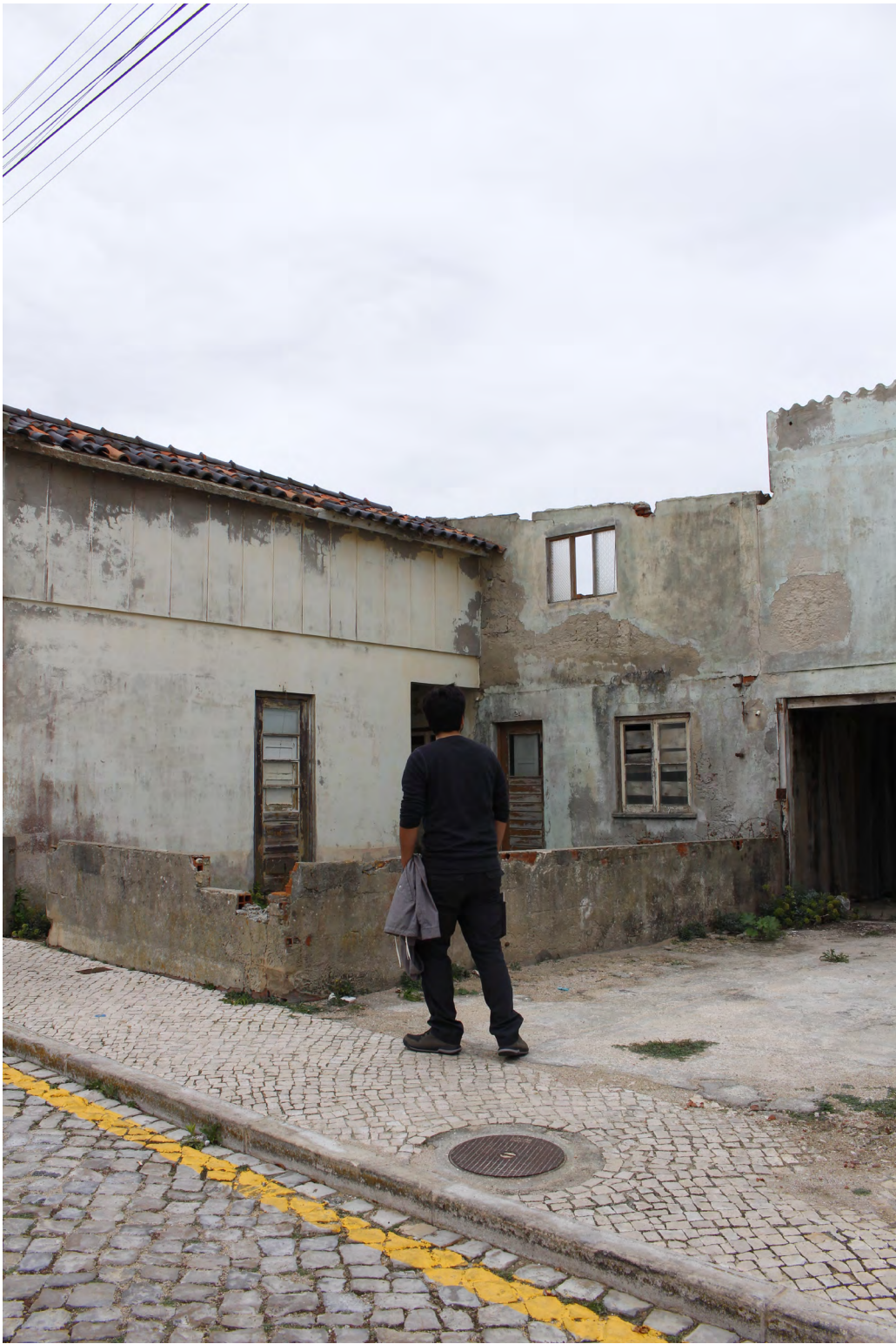
Figura 69: A habitação em ruína no lote da proposta.
