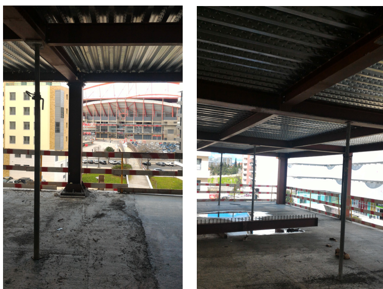
Figura 2.45 – Luxury Flats – Benfica Stadium , Lisboa (Metaloviana e SE2P, 2016). Exemplos de escoramento em vigas mistas aço-betão.
