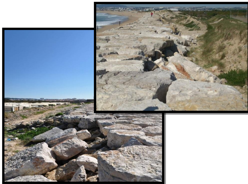
Figura 4.27- Fotos tiradas no local de danos na estrutura aderente de defesa costeira.
