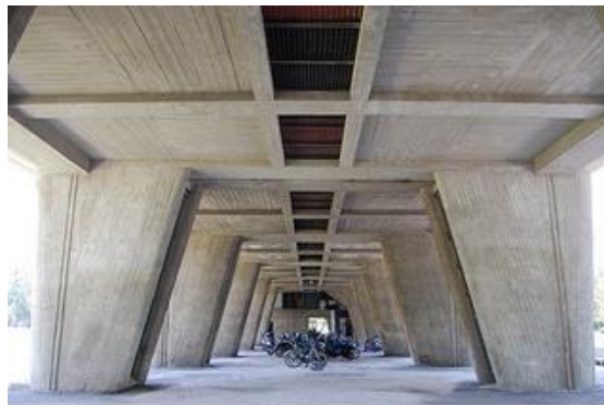
Figura 79: Vista da galeria de infraestruturas presente no topo dos pilotis e abaixo dos alojamentos
