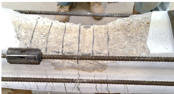
Figura 4.41 – Formação de fendas coincidente com a posição dos estribos na Viga3.
