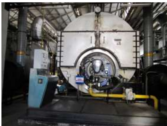
Figura 4.5 - Caldeira 1 ou 2 (são ambas iguais) equipadas com queimador dual (GN/Gasóleo)
