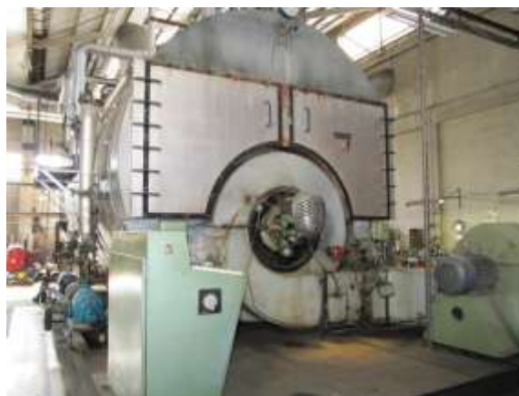
Figura 4.6 - Caldeira 3, equipada com queimador de Gasóleo
