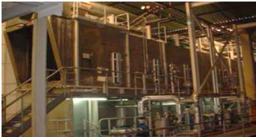
Figura 2.7 Túnel de Pré-Tratamento
