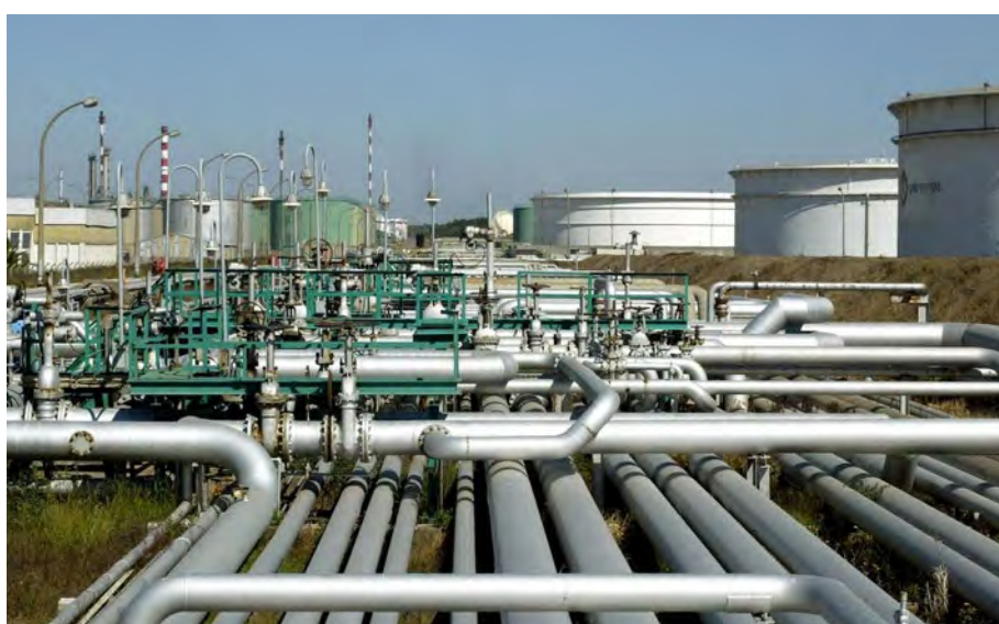
Fig.6: Vista dos pipelines da Refinaria Petrolífera de Leça da Palmeira
