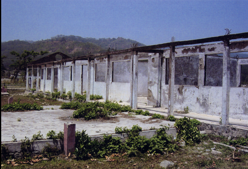
Fig.86 | Escola destruída em Gleno, Ermera.
