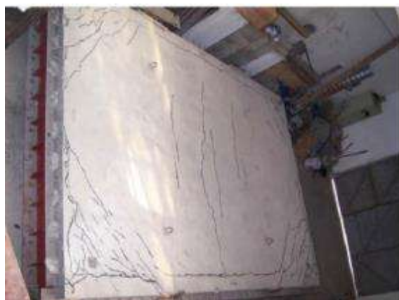
(c) Configuração fissuras no caso das lajes com cobrimento das armaduras de 21 mm
