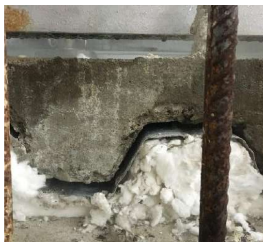
Figura 87 – Desprendimento da chapa perfilada do concreto
