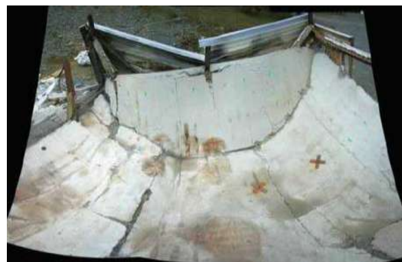
(g) Característica das fissuras após o ensaio
