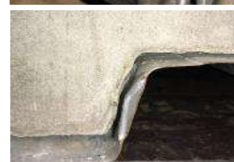
(d) Escorregamento e desprendimento da chapa
