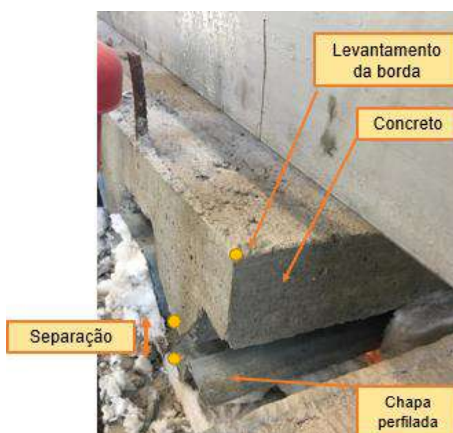
Figura 78 – Separação vertical concreto-chapa e levantamento de borda
