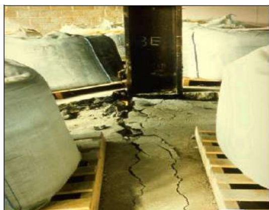
Figura 31 – Fissura em laje mista contínua: ensaio em Cardington, Inglaterra Fonte: Newman, Robinson e Bailey (2006)
