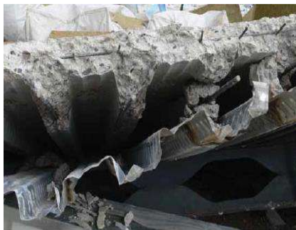
(b) Desprendimento chapa perfilada do concreto do estudo de Wald et al. (2010)
