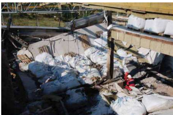
(f) Colapso da laje
