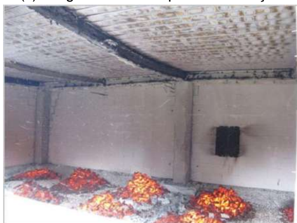
(e) Característica da laje pós-incêndio
