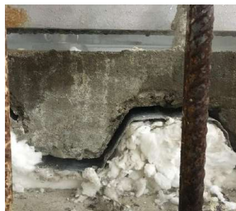
Figura 132 – Desprendimento da chapa
