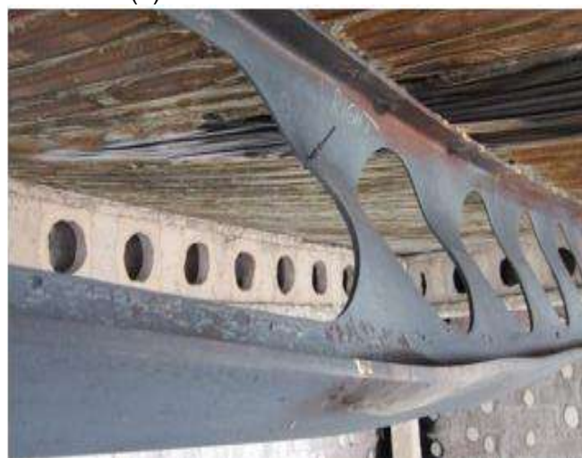
(d) Configuração vigas casteladas pós-incêndio
