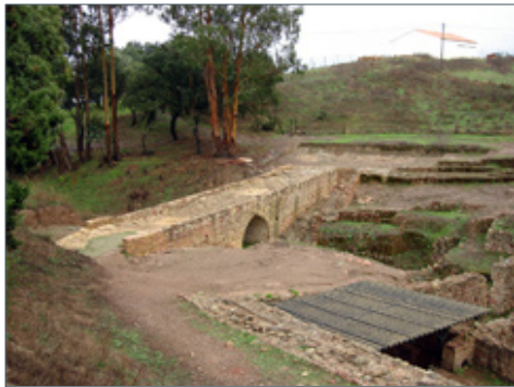
[Fig. 03] Degradação da cobertura de protecção dos mosaicos junto à ponte romana.
