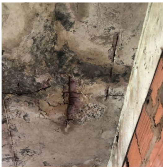
Figura (5.6) - Armaduras expostas e com corrosão, destacamento de betão. Arquivo pessoal (2020).
