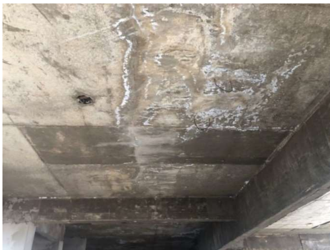
Figura (5.3) - Lajes com indícios de corrosão .Arquivo Pessoal (2020)
