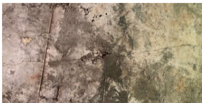
Figura (5.14) - Fissuras. Arquivo pessoal (2020).
