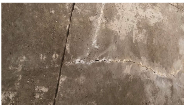
Figura (5.13) - Fissuras. Arquivo pessoal (2020).
