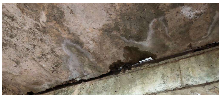
Figura (5.18) - Manchas e eflorescências nas alvenarias. Arquivo pessoal (2020).
