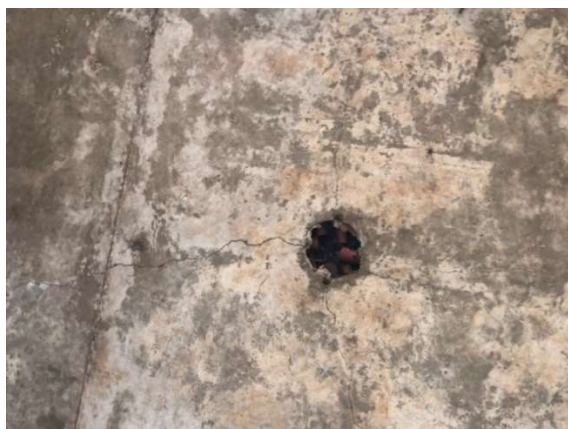
Figura (5.15) – Fissuras provenientes de instalações. Arquivo pessoal (2020).
