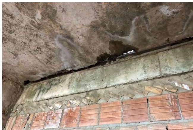
Figura (5.11) - Armaduras Expostas. Arquivo pessoal (2020).
