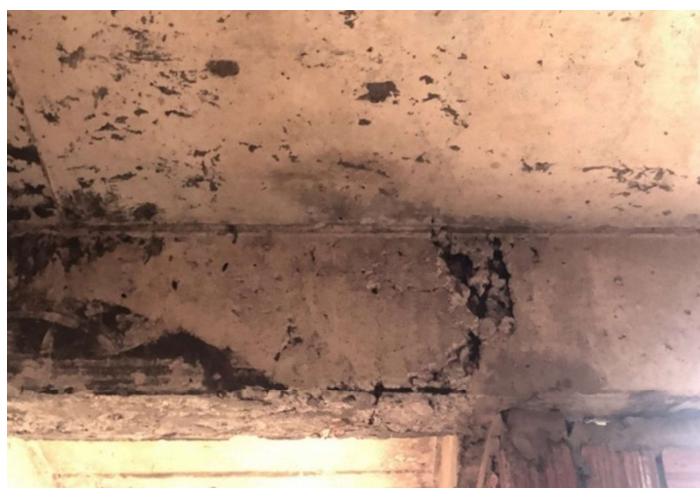
Figura (5.4) - Lajes com armadura expostas. Arquivo pessoal (2020)
