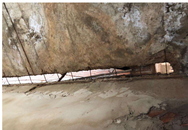
Figura (5.17) - Manchas e eflorescências nas alvenarias. Arquivo pessoal (2020).
