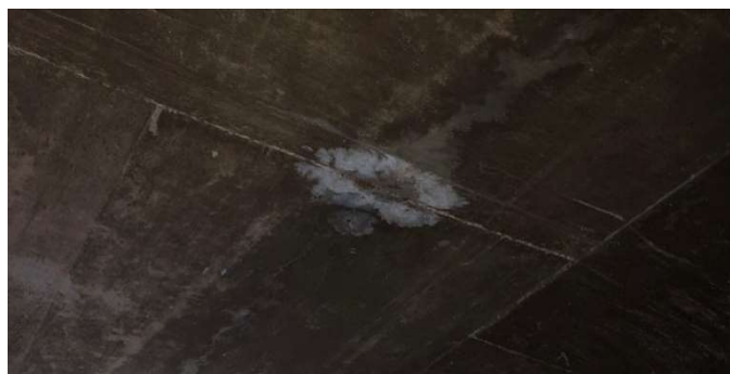
Figura (5.21) - Manchas e eflorescências nas alvenarias. (Arquivo pessoal,2020).
