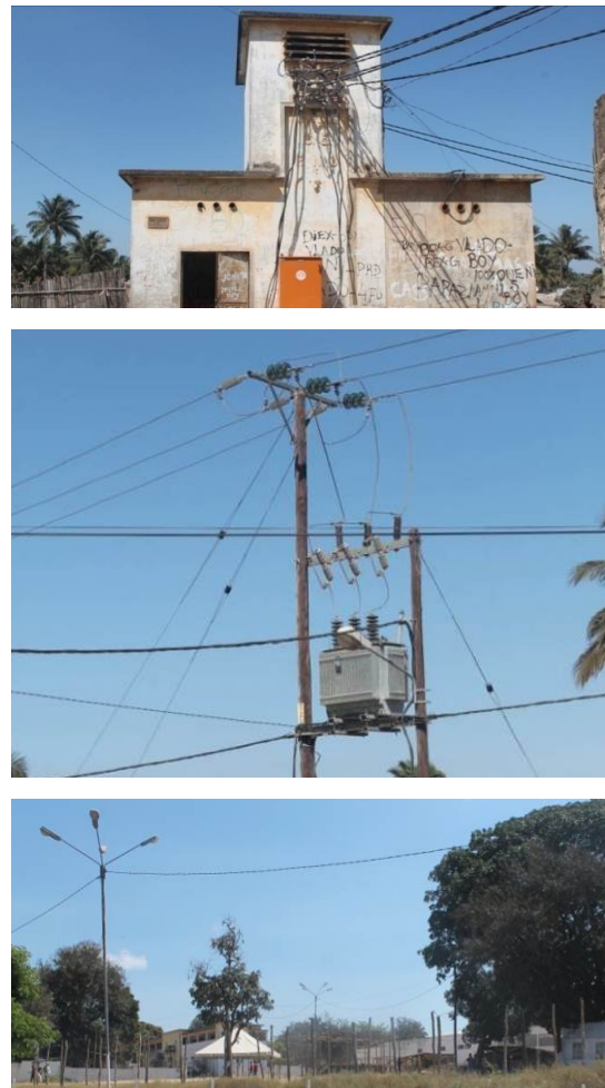
Figura 17. Rede elétrica (Posto de Transformação, Linhas de Média e Baixa Tensão) Fonte: (Autora)
