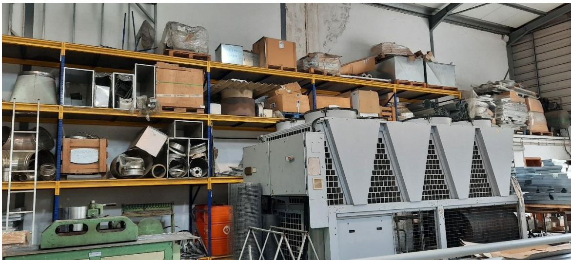
Figura 23 – Prateleiras de armazenamento e Chiller
