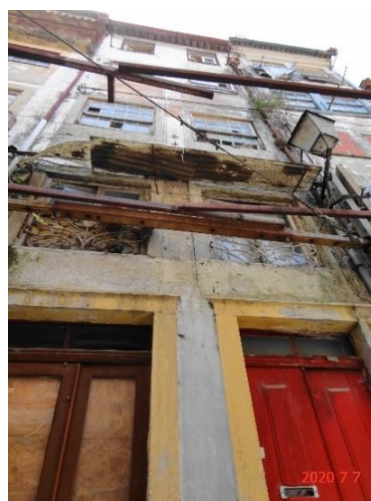
Degradação e Abandono
