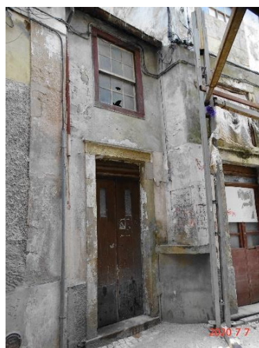
Degradação e Abandono
