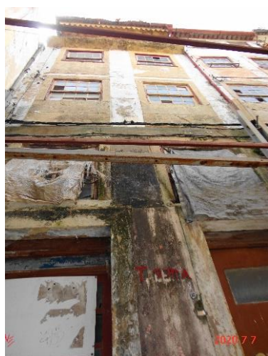
Degradação e Abandono
