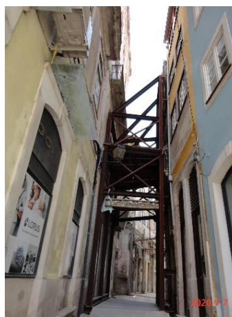
Conjunto urbano degradado
