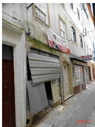
Edifício em obras paralisado há mais de um ano
