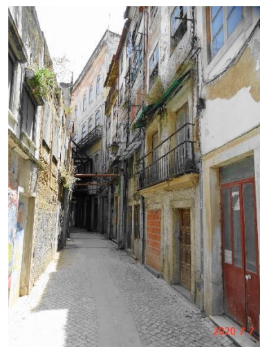
Conjunto urbano degradado
