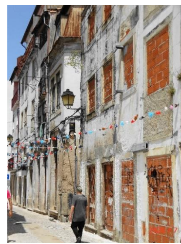
Conjunto urbano degradado
