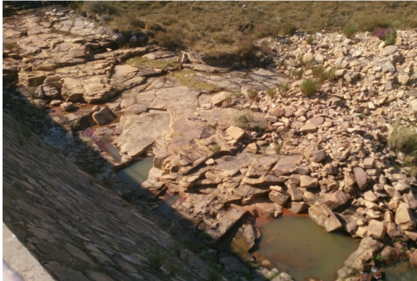
Figura 5.6 - Depósitos de material rochoso devido o galgamento da água.
