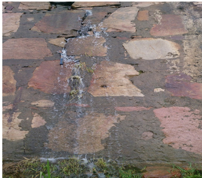
Figura 5.2 - Fugas de água registradas através do corpo da barragem.
