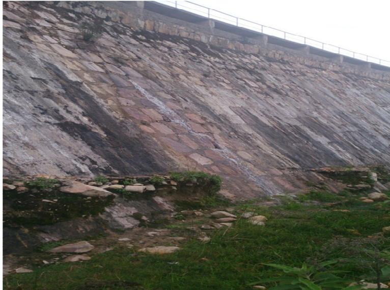
Figura 5.1 - Fundação da barragem desprotegida devido ao processo erosivo.
