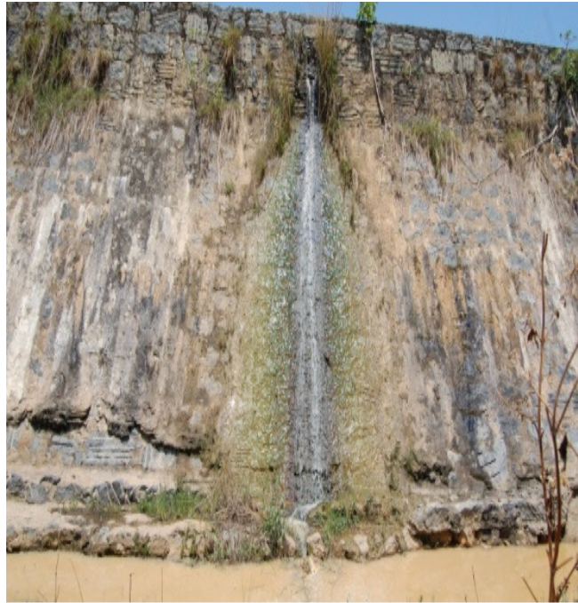
Figura 3.14 – Deterioração do corpo da barragem.
