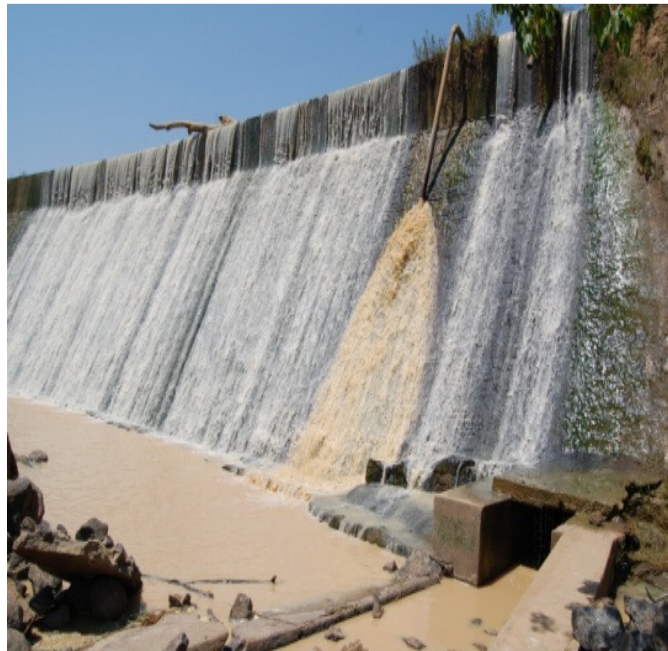
Figura 3.15 – Deterioração do corpo da barragem.
