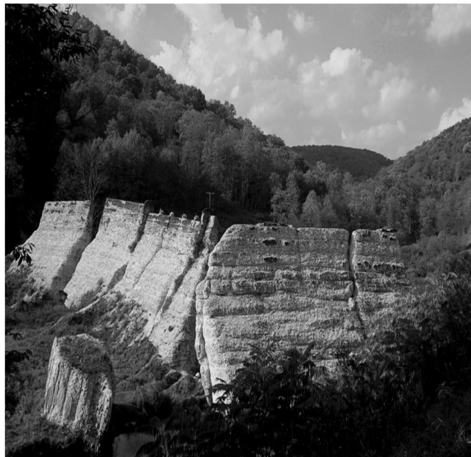
Figura 2.4 - Rotura da barragem de Austin.
