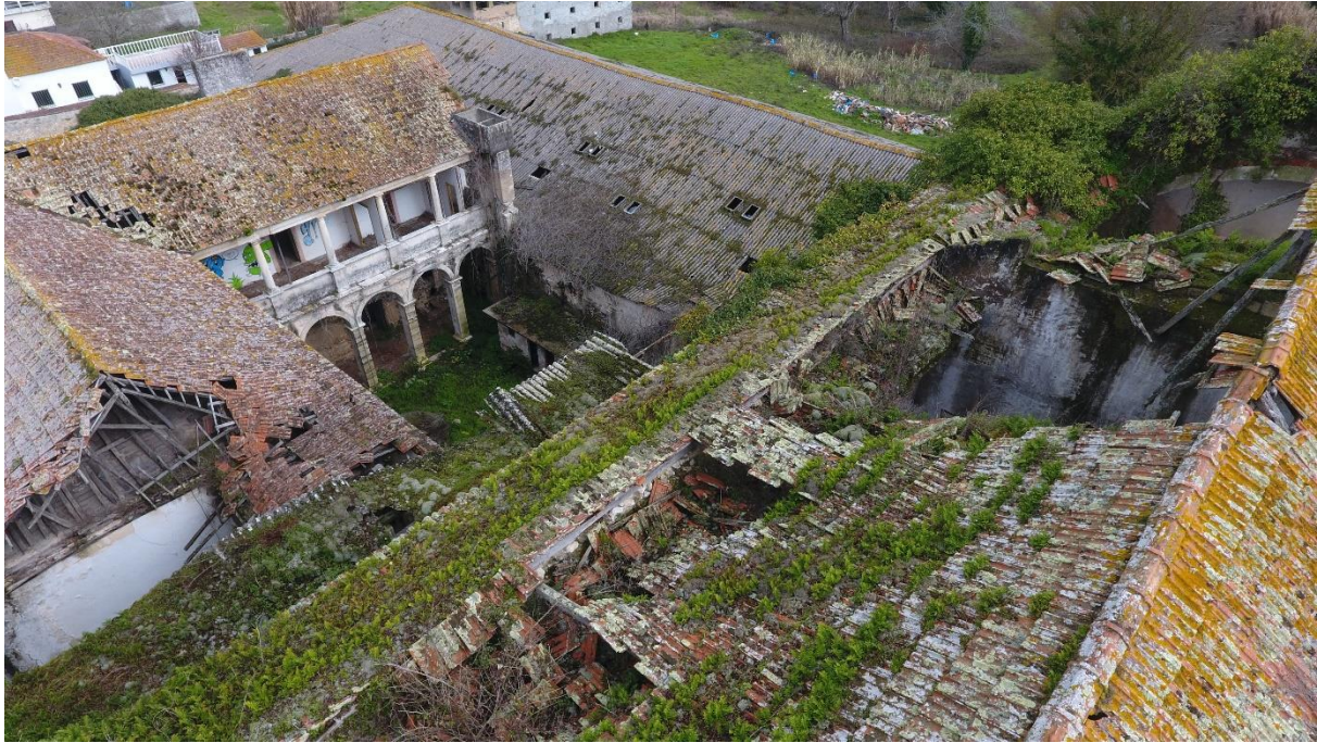
Imagem 6, Fotografia que demonstra o estado de conservação das coberturas
