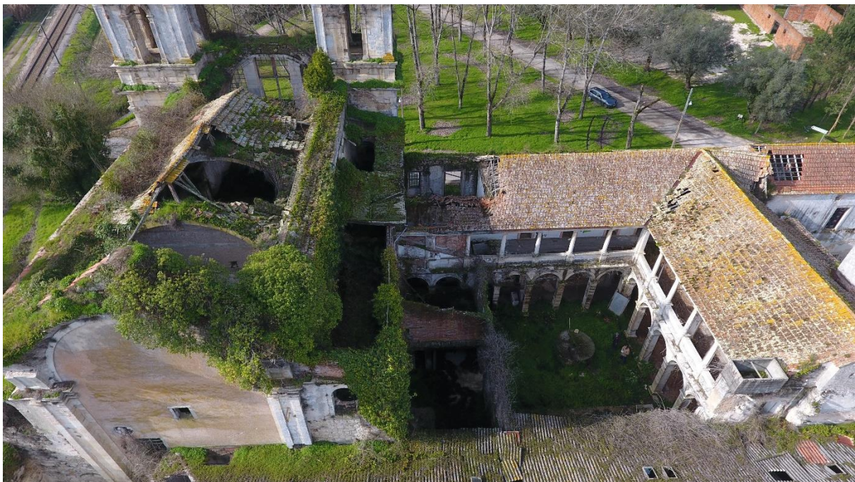
Imagem 7, Fotografia do estado de conservação da cobertura de igreja
