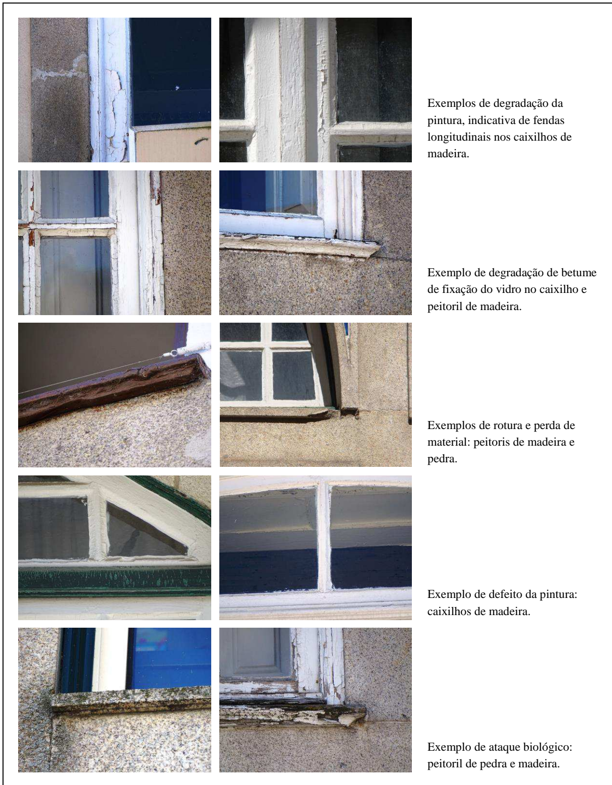
Figura 4.6 – Exemplos de patologias observadas em elementos de vãos envidraçados: caixilhos e peitoris
