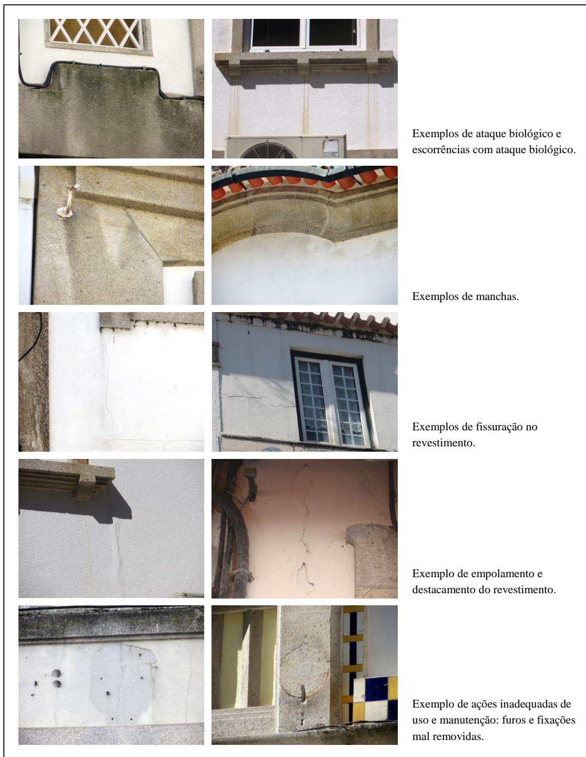
Figura 4.1 – Catálogo fotográfico ilustrativo de exemplos de patologias em revestimento de fachadas
