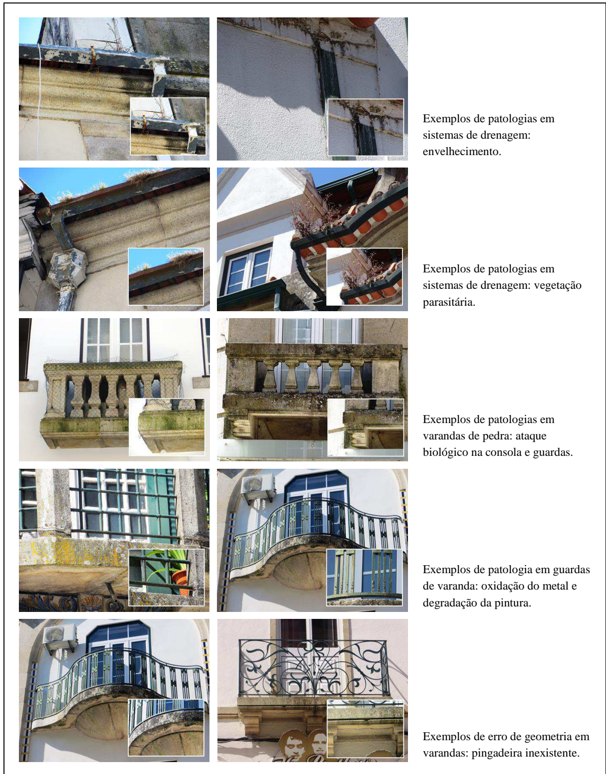
Figura 4.7 – Exemplos ilustrativos de patologias observadas em elementos singulares: rede de drenagem de águas pluviais e varandas
