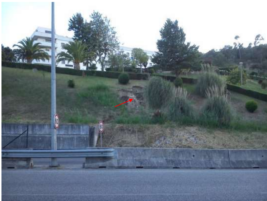
Figura nº12 - Vertente Hotel D. Luís, cicatriz de deslizamento recentemente ocorrido.
