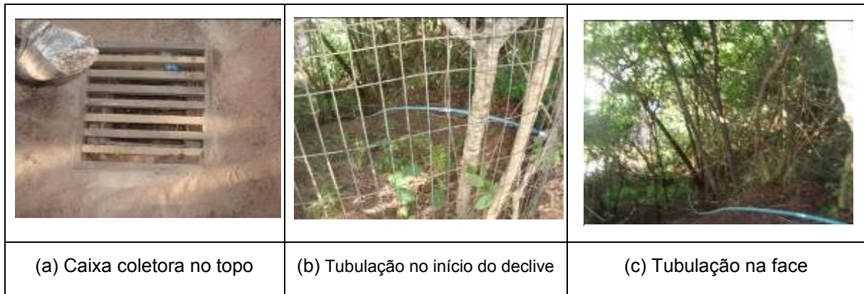
Figura 3.9 - Detalhes da caixa coletora de águas pluviais no topo da falésia da Ponta do Pirambu (Severo, 2011)
