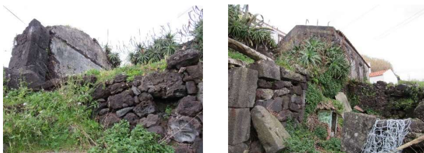
A B Figura 31 - Exemplos ilustrativos do nível de degradação I (estado de ruína)
