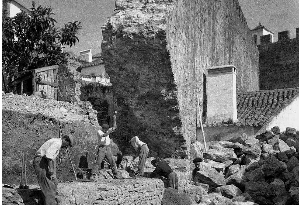
Fig. 22 - Obras de restauro da Muralha e Castelo de Óbidos. Fonte: Restos de Coleção.
