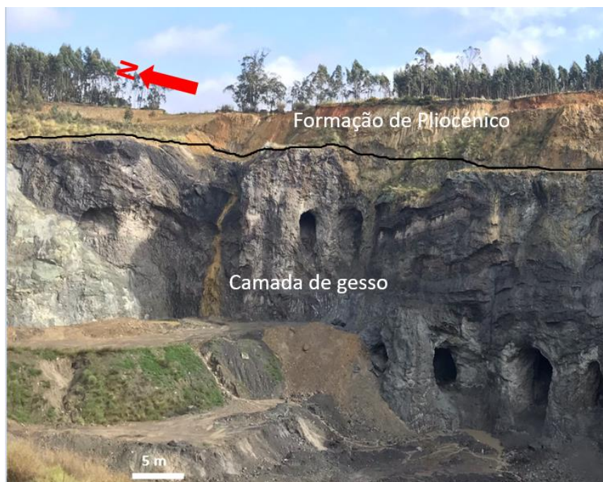
Figura 30 - Talude de pedra constituído por Formação Pliocénica sobre o maciço constituído por gesso.
