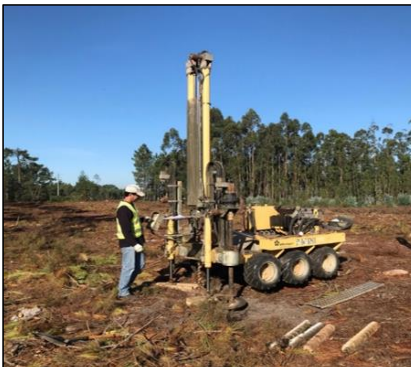
Figura 10 - Execução do ensaio de Penetração Dinâmica Super Pesada, DPSH 3, com equipamento da marca Pagani, modelo TG 73 – 200.
