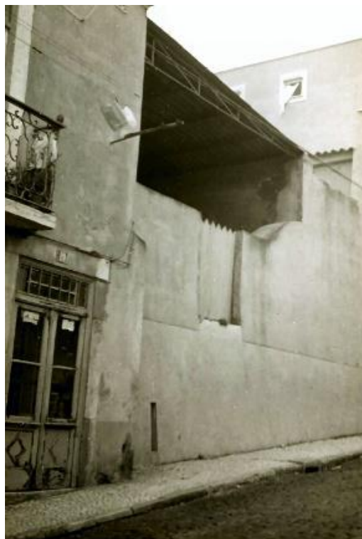
Fig. 9.5 – Fotografia do armazém na Rua da Verónica antes da intervenção de Bartolomeu Costa Cabral, s.d. [1973?]. Autor: Bartolomeu Costa Cabral. Fonte: Arquivo Bartolomeu Costa Cabral
