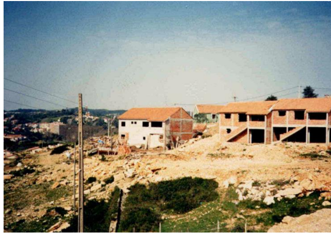
Fig. 11.24 – Construção de habitações no Bairro do Pego Longo. s.d. Fonte: Arquivo Bartolomeu Costa Cabral
