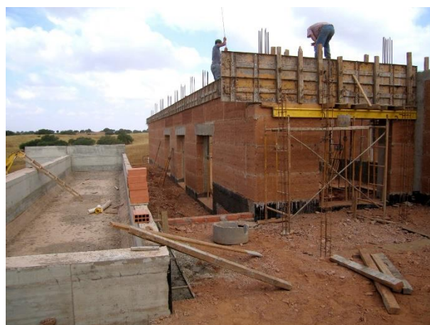
Fig. 12.15 – Construção da Casa em Taipa, 1 de junho de 2006. Fonte: Arquivo Bartolomeu Costa Cabral
