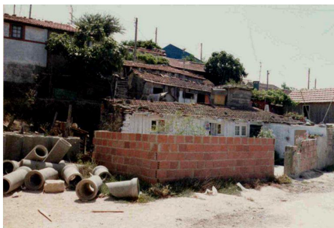
Fig. 11.23 – Construção de uma habitação no Bairro do Pego Longo. s.d. Fonte: Arquivo Bartolomeu Costa Cabral
