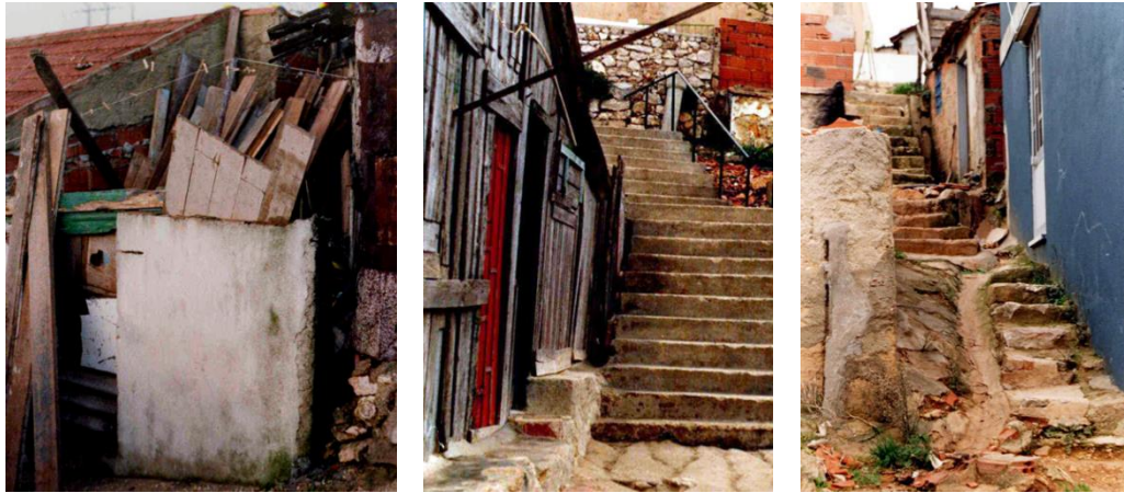
Fig. 11.3 – Bairro do Pego Longo antes da intervenção de Bartolomeu Costa Cabral, s.d. [1976?] Autor: Bartolomeu Costa Cabral. Fonte: Arquivo Bartolomeu Costa Cabral
