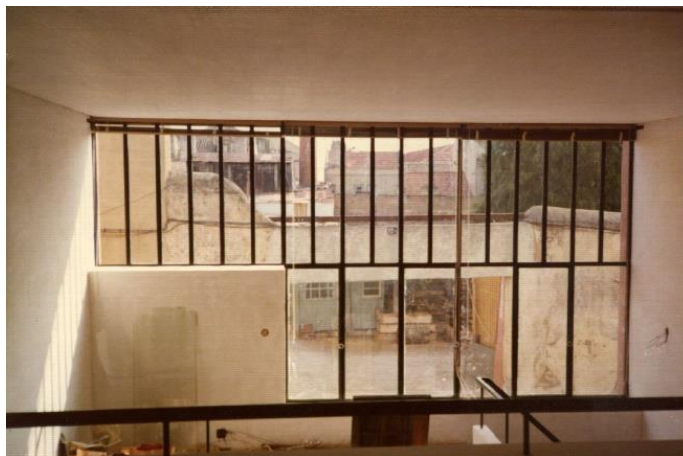
Fig. 9.7 – Vão da Casa na Rua da Verónica durante a obra, s.d. [1975?] Autor: Bartolomeu Costa Cabral. Fonte: Arquivo Bartolomeu Costa Cabral
