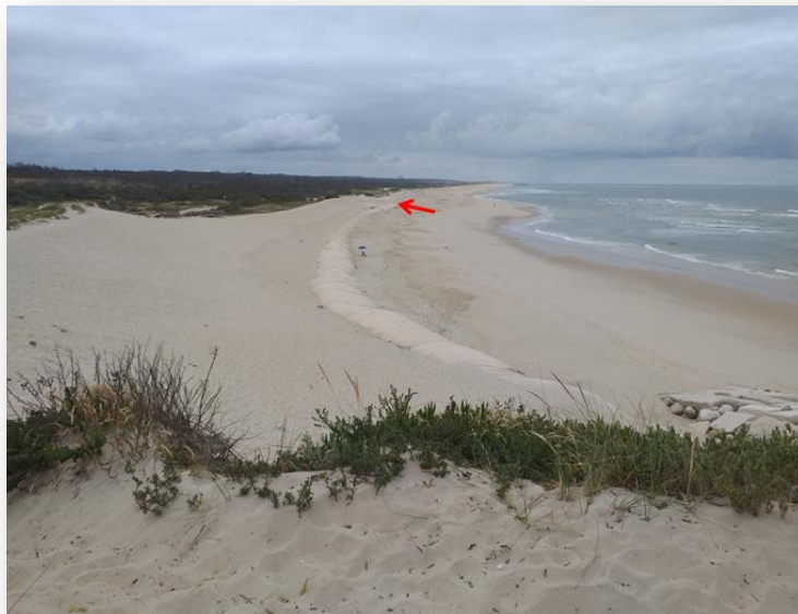
Figura 39 – → Rutura de geotubo na praia da Gala. Fonte: acervo pessoal, 6 de junho de 2020.
