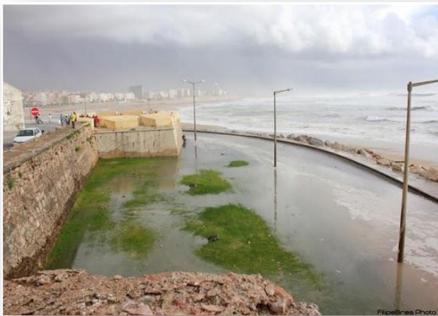
Figura 36 – Efeito de galgamento costeiro no Forte de Buarcos. Fonte: Fotografia de Filipe Brás, 9 de outubro de 2010, in H. F. Almeida, 2019, p.120.
