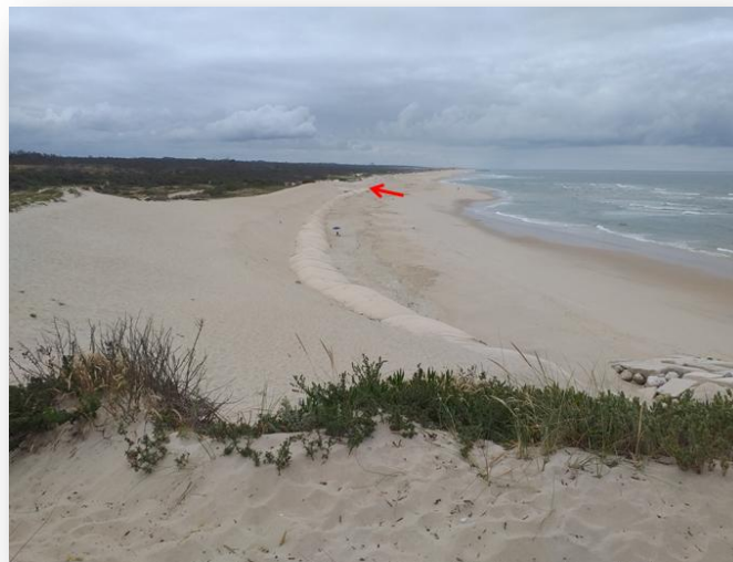
Figura 46 – Aplicação de geotubos na praia da Gala como estratégia de contrariar a erosão litoral. Fonte: acervo pessoal.
