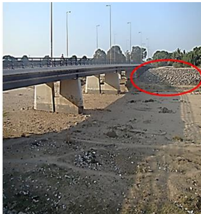
Figura 4 - Leito do rio Cavaco durante a estação seca. O círculo a vermelho corresponde a um dique lateral. Notar o lixo disperso no leito seco do rio.
