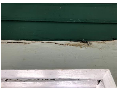
Figura 19: Solar da Beira Alta - Fissuração com manchas de humidade e bolor. (Fonte: Autor, 2019)
