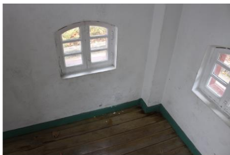
Figura 21: Solar da Beira Alta - Sujidade, destacamento e empolamento do revestimento devido a humidade. (Fonte: Autor, 2019)
