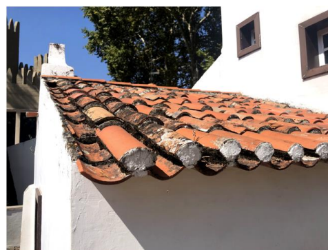
Figura 6: Casa da Nazaré - Fratura de telha, argamassa excessiva e presença de musgos, bolores e vegetação. (Fonte: Autor, 2019)
