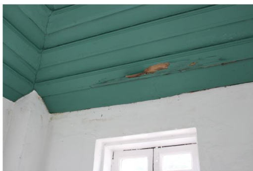
Figura 41: Solar da Beira Alta - Descasque da tinta no teto. (Fonte: Autor, 2019)
