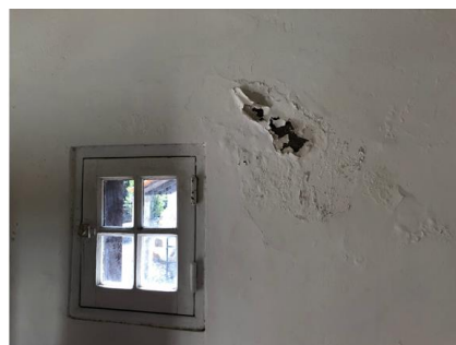
Figura 18: Casa da Nazaré - Destacamento e empolamento do revestimento devido a humidade. (Fonte: Autor, 2019)
