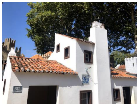
Figura 4: Casa da Nazaré - Fratura de telha, argamassa excessiva e presença de musgos, bolores e vegetação. (Fonte: Autor, 2019)
