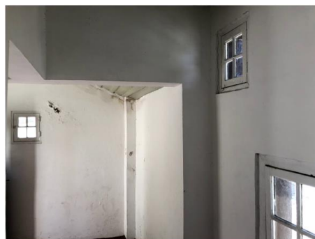
Figura 28: Casa da Nazaré - Manchas de humidade, fissuração e queda de reboco devido à presença de cripto florescências. (Fonte: Autor, 2019)
