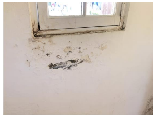
Figura 36: Casa da Nazaré - Presença de humidade na caixilharia com destacamento e empolamento do revestimento. (Fonte: Autor, 2019)
