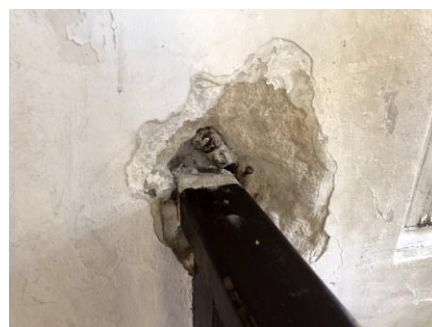
Figura 26: Casa da Nazaré - Queda de reboco. (Fonte: Autor, 2019)
