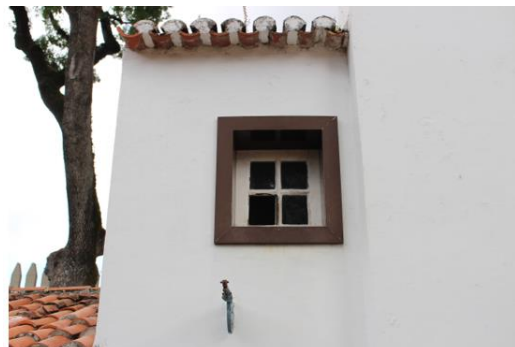
Figura 40: Casa da Nazaré - Erros de construção dos peitoris integrados na fachada (com projeção reduzida, sem inclinação e sem pingadeira). (Fonte: Autor, 2019)
