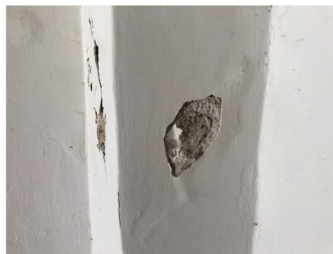
Figura 32: Casa da Nazaré - Fissuração e queda de reboco devido à presença de cripto florescências. (Fonte: Autor, 2019)
