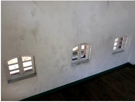
Figura 33: Solar da Beira Alta - Empenamento da caixilharia e ausência de vidros. (Fonte: Autor, 2019)
