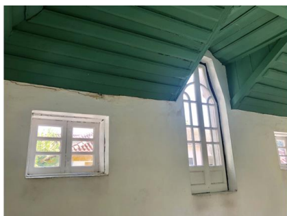
Figura 15: Solar da Beira Alta - Fissuração com manchas de humidade e bolor. (Fonte: Autor, 2019)
