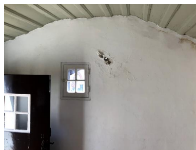
Figura 16: Casa da Nazaré: Destacamento e empolamento do revestimento devido a humidade. (Fonte: Autor, 2019)
