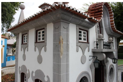
Figura 9: Solar da Beira Alta - Fissuração devida retração do revestimento e queda de reboco. (Fonte: Autor, 2019)
