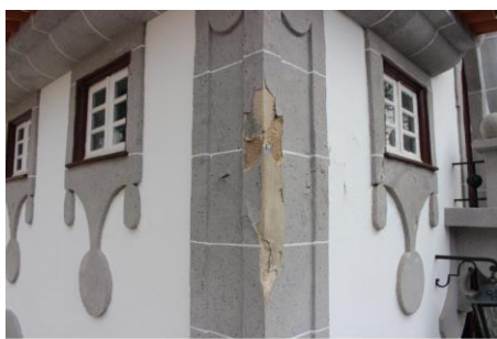
Figura 11: Solar da Beira Alta - Fissuração devida retração do revestimento e queda de reboco. (Fonte: Autor, 2019)
