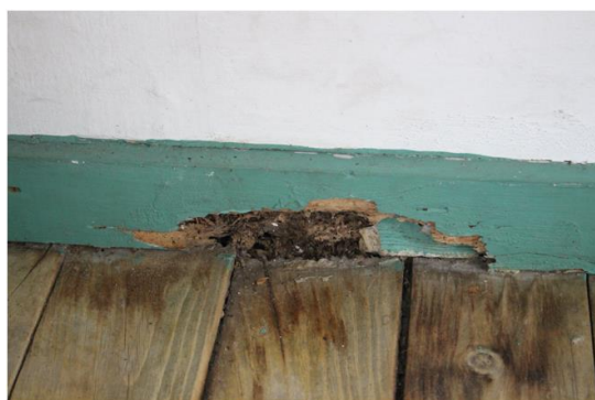
Figura 49: Solar da Beira Alta - Presença de manchas de humidade no pavimento de madeira com ataque biológico no rodapé. (Fonte: Autor, 2019)
