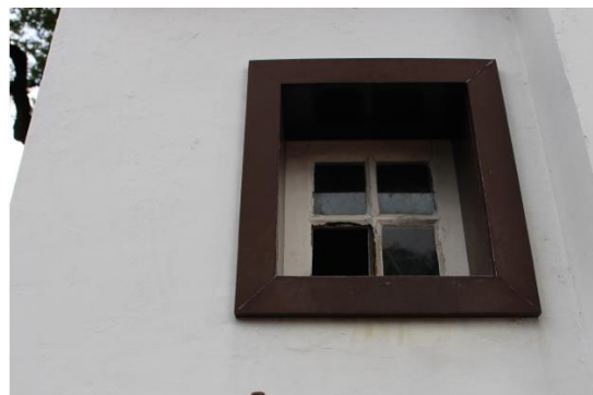
Figura 54: Casa da Nazaré - Erros de construção dos peitoris integrados na fachada (com projeção reduzida, sem inclinação e sem pingadeira). (Fonte: Autor, 2019)
