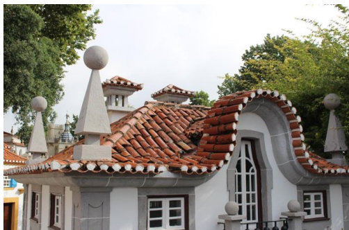
Figura 3: Solar da Beira Alta - Fratura de telha, argamassa excessiva e presença de musgos, bolores e vegetação. (Fonte: Autor, 2019)
