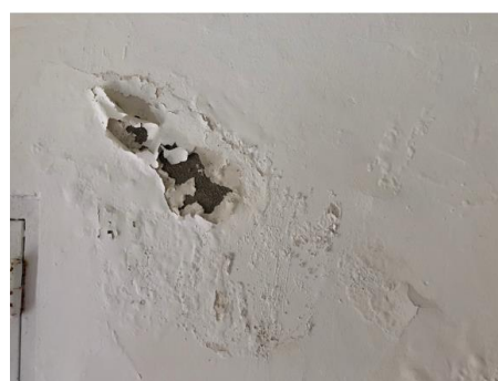
Figura 20: Casa da Nazaré - Destacamento e empolamento do revestimento devido a humidade. (Fonte: Autor, 2019)
