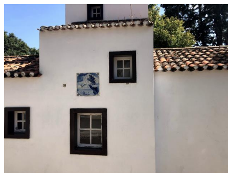
Figura 10: Casa da Nazaré - Fissuração e queda de reboco. (Fonte: Autor, 2019)
