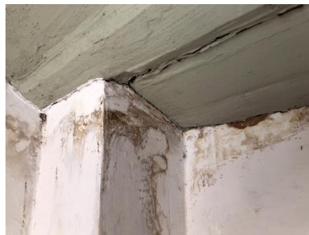
Figura 30: Casa da Nazaré - Manchas de humidade e bolor. (Fonte: Autor, 2019)
