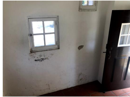
Figura 34: Casa da Nazaré - Presença de humidade na caixilharia com destacamento e empolamento do revestimento. (Fonte: Autor, 2019)
