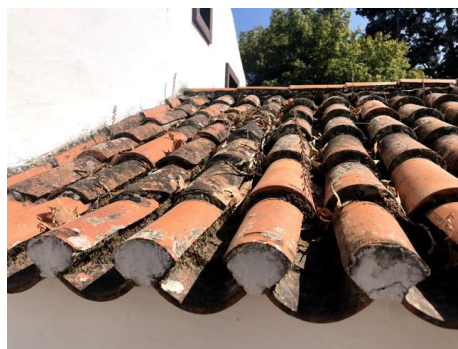
Figura 8: Casa da Nazaré - Fratura de telha, argamassa excessiva e presença de musgos, bolores e vegetação. (Fonte: Autor, 2019)
