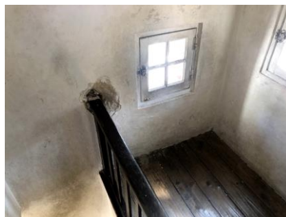
Figura 22: Casa da Nazaré - Queda de reboco. (Fonte: Autor, 2019)
