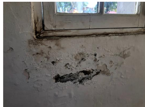
Figura 38: Casa da Nazaré - Presença de humidade na caixilharia com destacamento e empolamento do revestimento. (Fonte: Autor, 2019)
