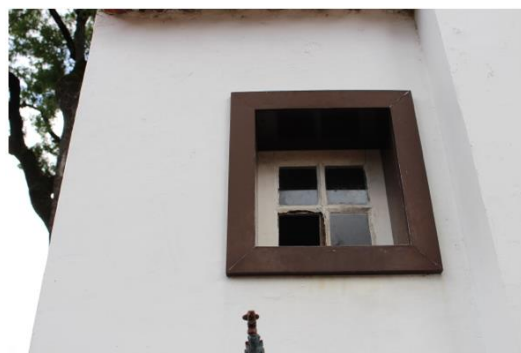
Figura 72: Casa da Nazaré - Erros de construção dos peitoris integrados na fachada (com projeção reduzida, sem inclinação e sem pingadeira). (Fonte: Autor, 2019)
