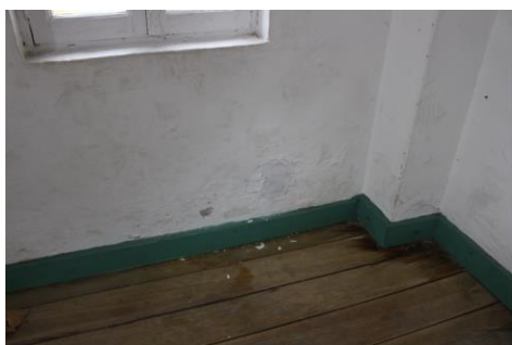
Figura 23: Solar da Beira Alta - Sujidade, destacamento e empolamento do revestimento devido a humidade. (Fonte: Autor, 2019)
