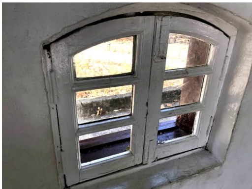
Figura 47: Solar da Beira Alta - Empenamento da caixilharia e ausência de vidros. (Fonte: Autor, 2019)
