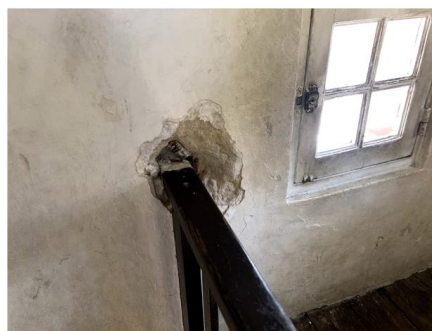
Figura 24: Casa da Nazaré - Queda de reboco. (Fonte: Autor, 2019)
