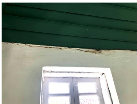
Figura 17: Solar da Beira Alta - Fissuração com manchas de humidade e bolor. (Fonte: Autor, 2019)
