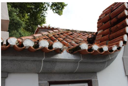
Figura 5: Solar da Beira Alta - Fratura de telha, argamassa excessiva e presença de musgos, bolores e vegetação. (Fonte: Autor, 2019)
