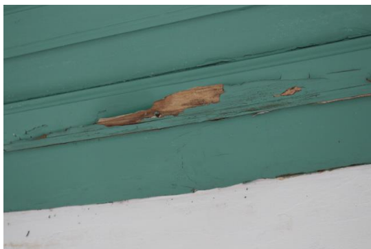
Figura 63: Solar da Beira Alta - Descasque da tinta no teto. (Fonte: Autor, 2019)
