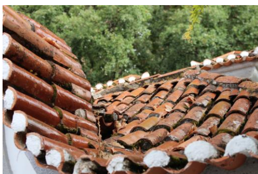
Figura 7: Solar da Beira Alta - Fratura de telha, argamassa excessiva e presença de musgos, bolores e vegetação. (Fonte: Autor, 2019)
