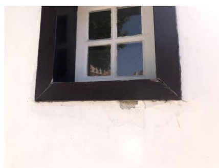
Figura 14: Casa da Nazaré - Fissuração e queda de reboco. (Fonte: Autor, 2019)
