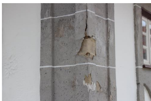
Figura 13: Solar da Beira Alta - Fissuração devida retração do revestimento e queda de reboco. (Fonte: Autor, 2019)
