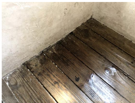
Figura 48: Casa da Nazaré - Presença de fissuração com ataque biológico. (Fonte: Autor, 2019)
