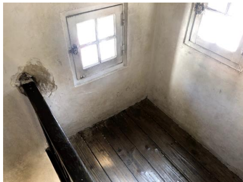
Figura 46: Casa da Nazaré - Presença de fissuração com ataque biológico. (Fonte: Autor, 2019)
