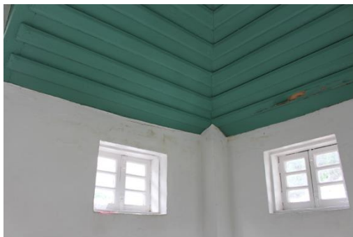
Figura 39: Solar da Beira Alta - Descasque da tinta no teto. (Fonte: Autor, 2019)
