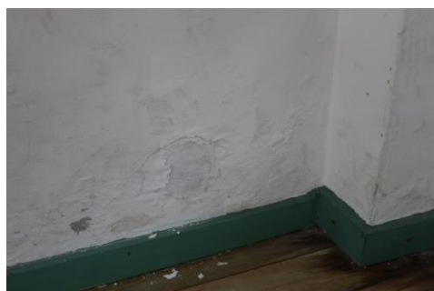
Figura 25: Solar da Beira Alta - Sujidade, destacamento e empolamento do revestimento devido a humidade. (Fonte: Autor, 2019)
