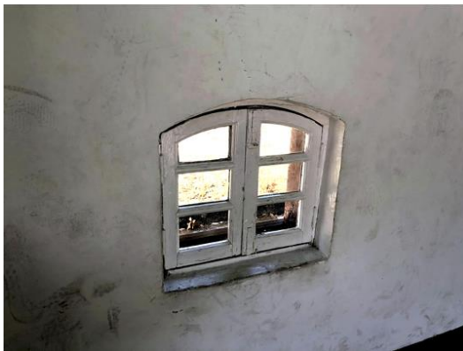
Figura 35: Solar da Beira Alta - Empenamento da caixilharia e ausência de vidros. (Fonte: Autor, 2019)
