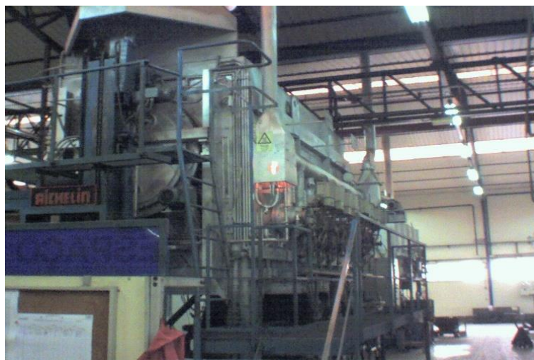
Figura 2.4 - Fornos de Austenização (SRAMPORT, 2010)
