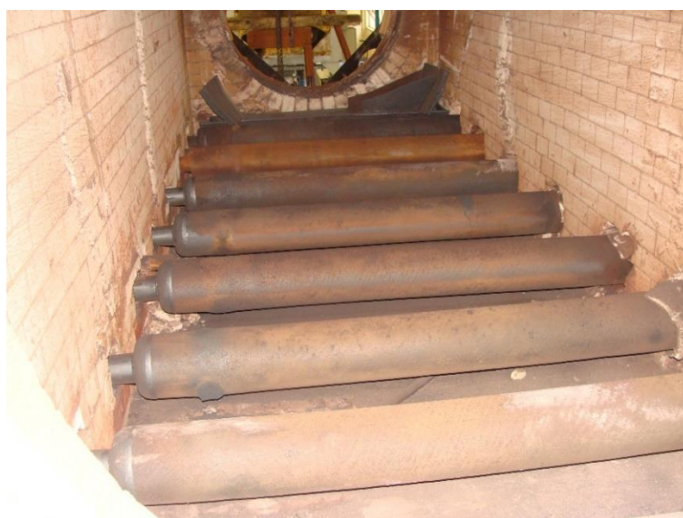
Figura 2.5 - Interior dos fornos de austenização após desmantelamento da retorta (SRAMPORT, 2013)
