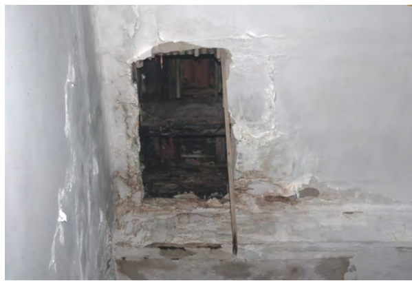
Fig. 83- Estado atual do fasquiado dos tetos a reabilitar
