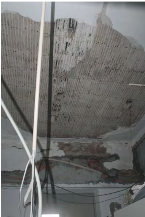
Fig. 84- Estado atual do fasquiado dos tetos a reabilitar
