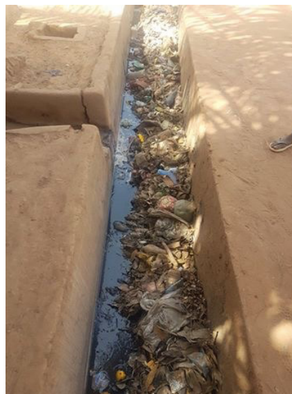
Figura 19- Valeta de Drenagem
