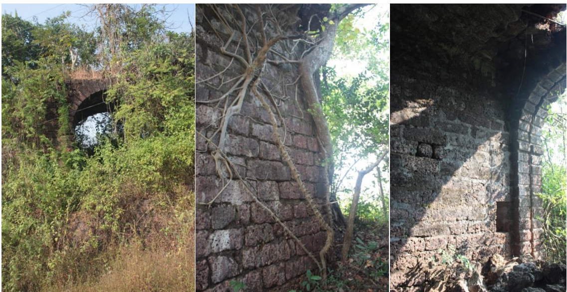
Imagens 3.83 a 3.86 Porta de Moulá: num estado de conservação semelhante ao da Porta e Passo do Mangueiral (em ruína mas identificável).
