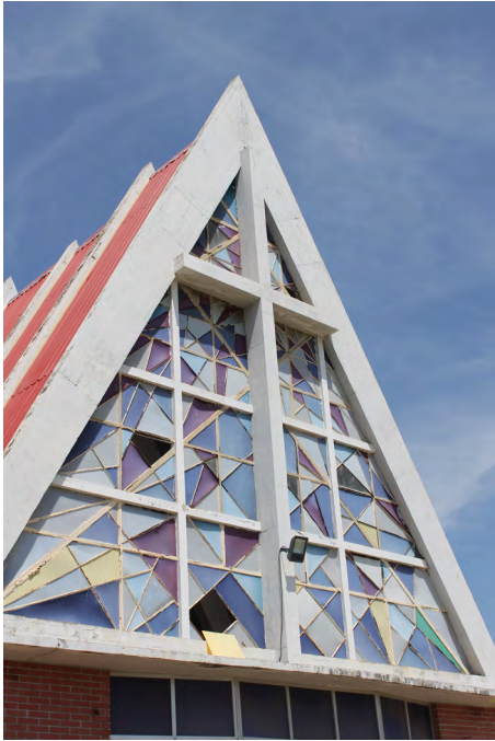
Fig. 121 Sé Catedral do Sumbe, marcas de vandalismo.
