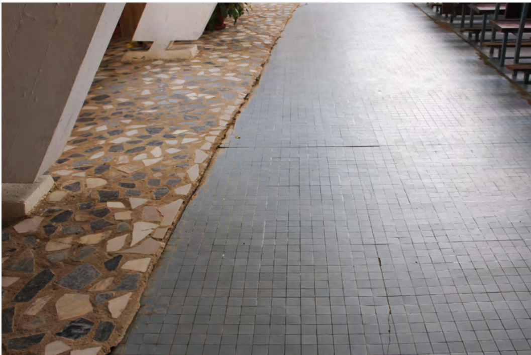
Fig. 123 Sé Catedral do Sumbe, alteração do pavimento.
