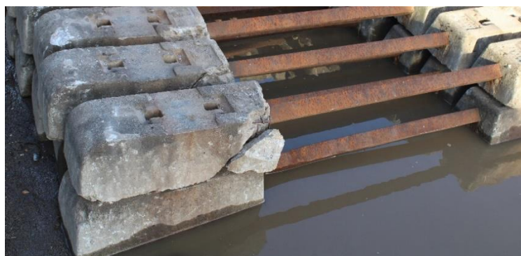
Figura A3.1 – Separação entre o bloco de betão e a cantoneira metálica.
