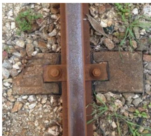
Figura A3.2 – Degradação da travessa bibloco devido à corrosão da cantoneira metálica e do carril (Mourão, 2017).
