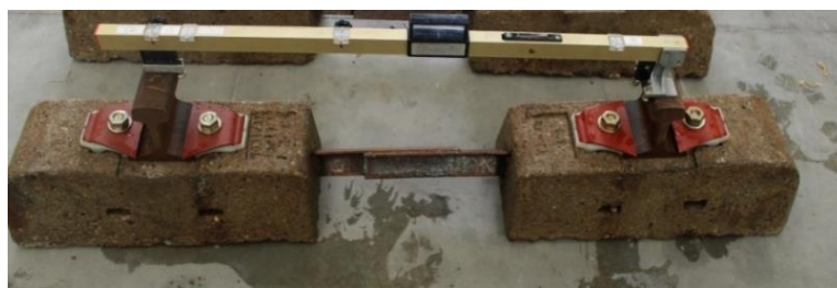
Figura 3.17 – Nivelamento transversal das TBB (BB2) adaptadas utilizando a régua de bitola da IP.
