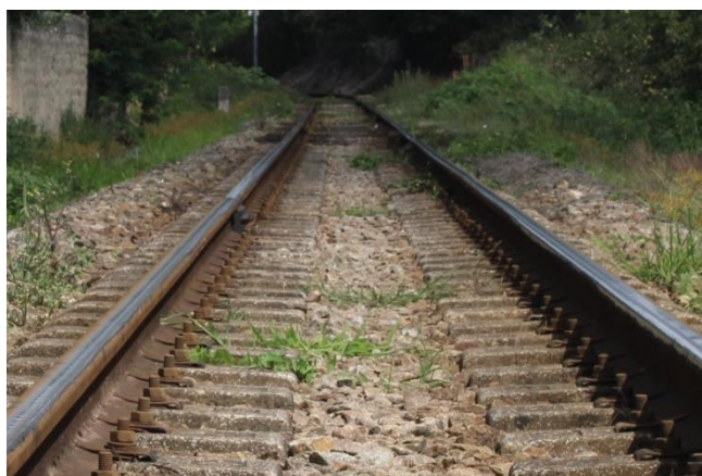
Figura 3.11 – Colmatação preenchida por vegetação – troço experimental (km 26+789 e km 26+863).
