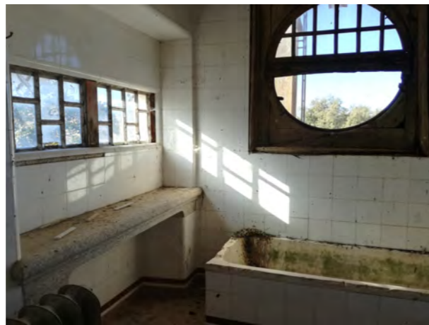
Figura 75: Instalação sanitária dos funcionários internos.
