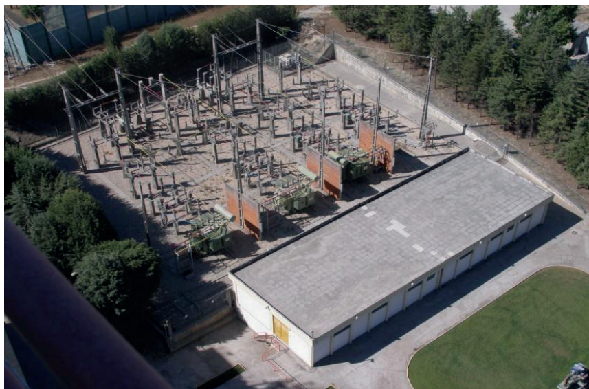
Figura 7. Subestação Cimpor Souselas [Fonte: Cimpor]
