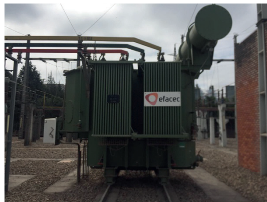
Figura 12. Transformador de potência 3 (30MVA) da subestação do CPS.
