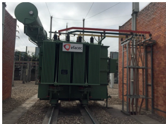
Figura 11. Transformador de potência 2 (12MVA) da subestação do CPS.
