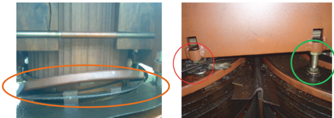
Figura 9. Transformador em avaria: Do lado esquerdo, anel metálico de aperto da fase U levantado e do lado direito perno da fase W fundido devido aos esforços de curto circuito criados pelo defeito.
