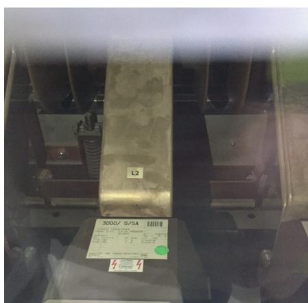
Figura 15. Transformador de corrente no lado da alta tensão do TP3.
