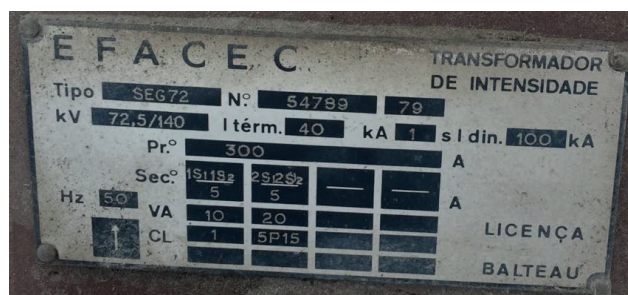
Figura 14. Chapa de características do transformador de corrente do TP3 com uma razão de transformação de 300/5A.
