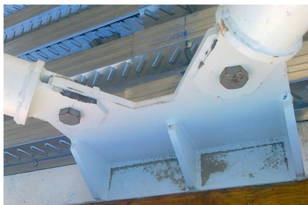
Figura 3.11 - Manipulação deficiente em estaleiro dos componentes metálicos e consequente perda localizada do tratamento superficial.
