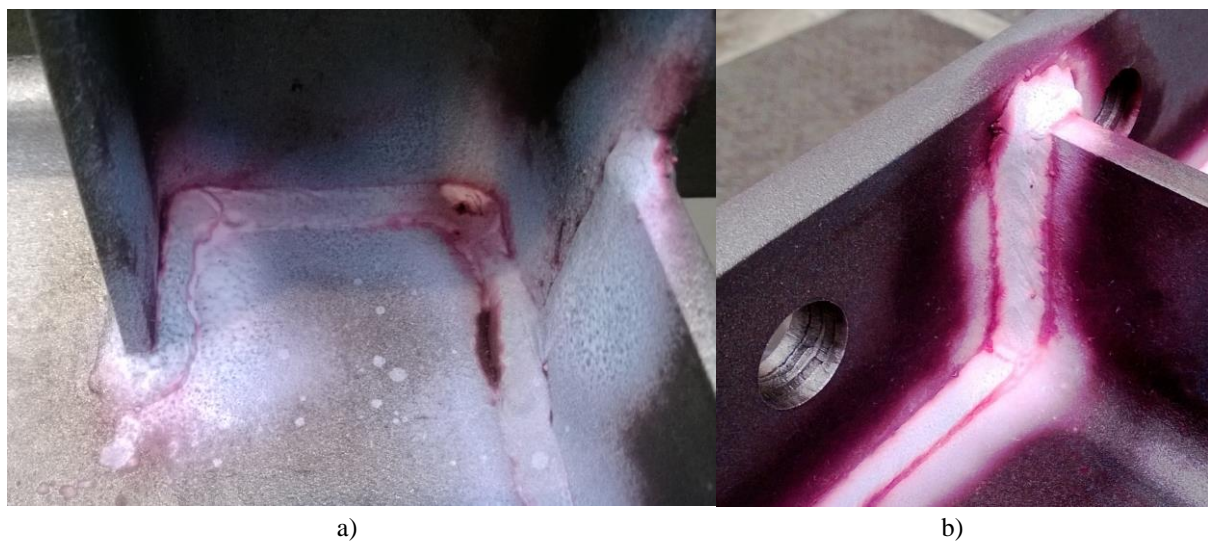
Figura 6.57 - Confirmação de colagens com líquidos penetrantes
