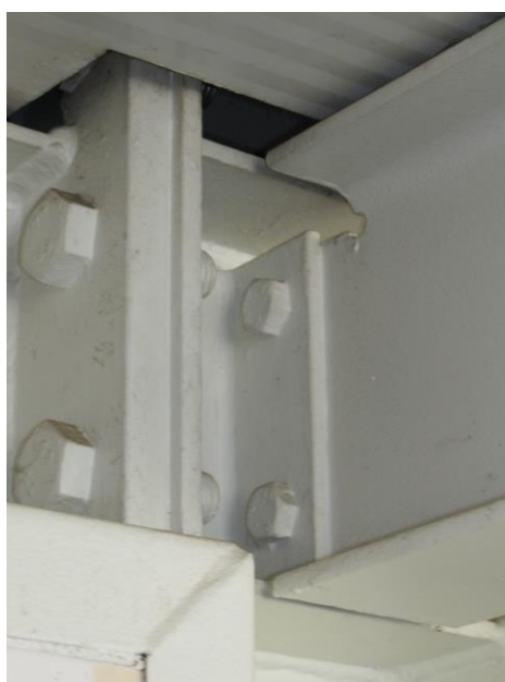
Figura 5.15 - Correto tratamento de entalhe reentrante encontrado em edifício existente.
