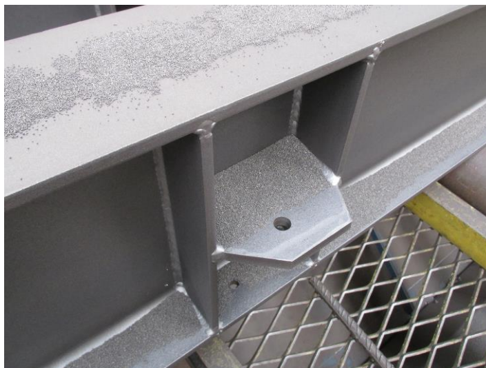
Figura 2.32 - Aspeto de peça após decapagem, momento ideal para verificar as imperfeições do material base e cordões de soldadura
