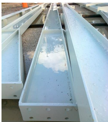
Figura 3.10 - Acumulação de águas no interior da componente não evitada em estaleiro.
