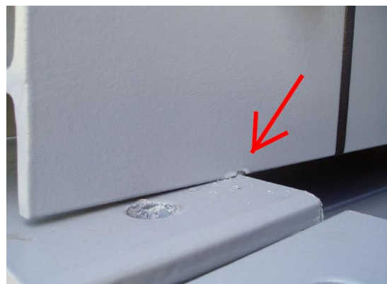
Figura 3.15 - Dano do tratamento de superfície por falta de barrote de madeira com altura suficiente entre os componentes.
