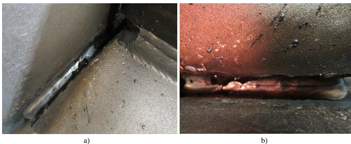
Figura 6.66 - Ocorrência de nova fissuração do cordão de raiz após a 2ª tentativa
