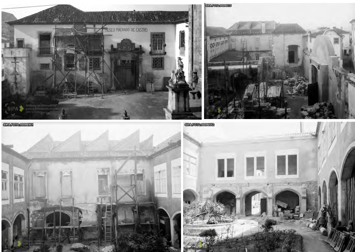
Figura 6.6 – Obras na fachada do museu, s.d.; obras na Ala Norte do Museu em 1934; e situação dos pátios a norte em 1939. (Registo SIPA)
