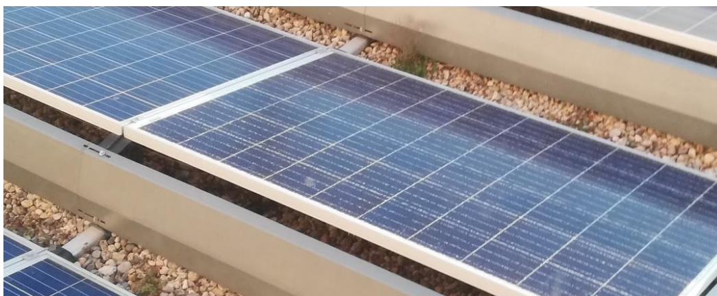
Figura 19 - Painel do sistema PV conectado ao inversor nascente com o vidro fotovoltaico quebrado (situa-se no piso 5, torre T)
