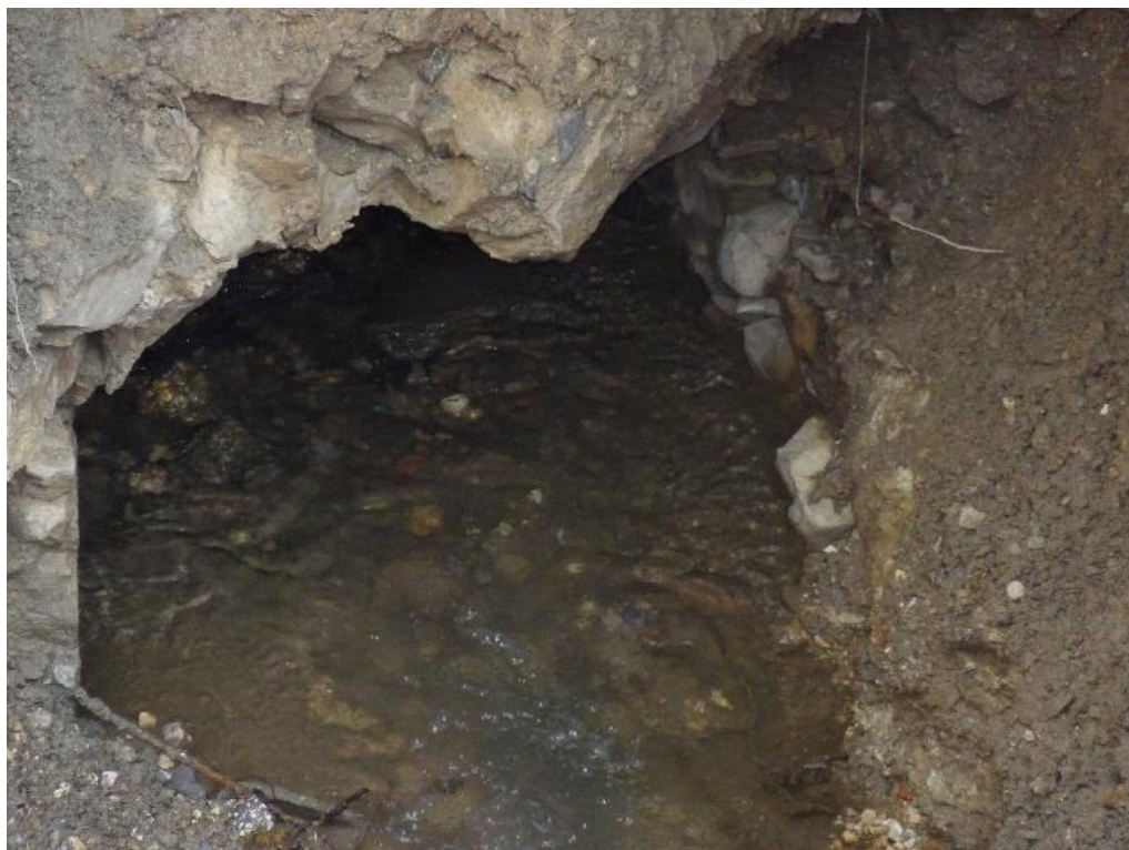
Figura 42 - Foto do interior do aluimento (notar os blocos de rocha no leito da linha de água, bem como a fracção mais argilosa no material rochoso desagregado); (foto do autor, 18 de Abril 2018).
