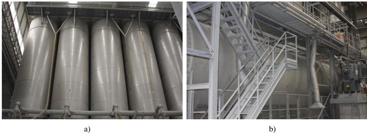
Figura 3.3 – Armazenamento e moagem de matérias-primas: a) Silos de armazenamento de matérias –primas; b) Cilindro de moagem
