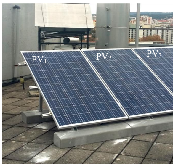
Figura 3.2. Instalação experimental – disposição dos painéis PV.
