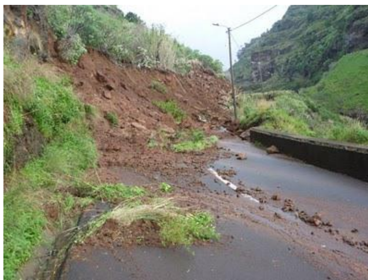
Figura 39 - Vista Sul do acesso ao Jardim do Mar bloqueado por derrocada, fevereiro de 2010
