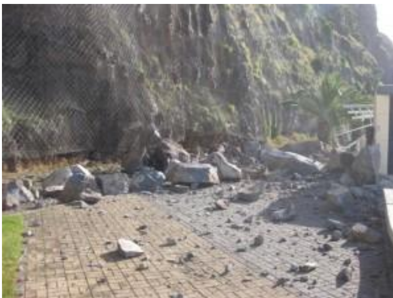
Figura 40 - Queda de blocos na Marginal da Vila da Calheta
