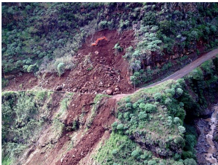
Figura 38 - Acesso ao Jardim do Mar bloqueado por derrocada, fevereiro de 2010
